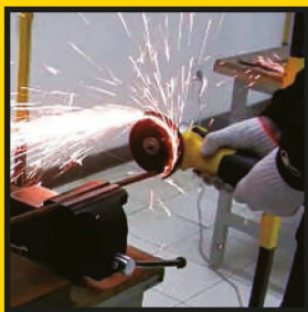
1 Corte de barras de refuerzo, pulido de líneas de soldadura. Pulidora Angular STGS6115/7115/8115 /1045
